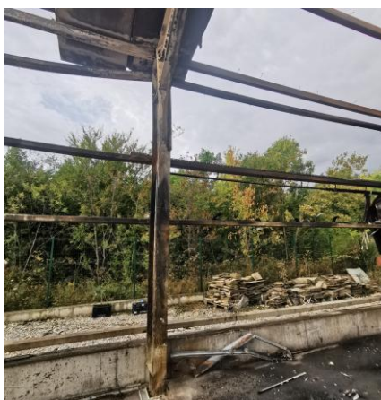
Фиг. 3.6. Изкривена стойка (колона) от рамката, следствие от пожара
