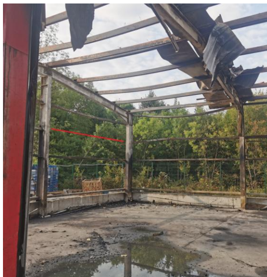
Фиг. 3.1. Напълно разрушени изолационни слоеве
