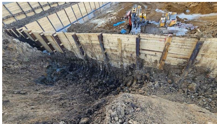
Фиг. 3. Изглед зад берлинската стена с изкопаната почва, преди да е направен обратният насип
