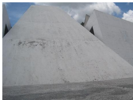
Фиг. 9. Състояние на облицовката
