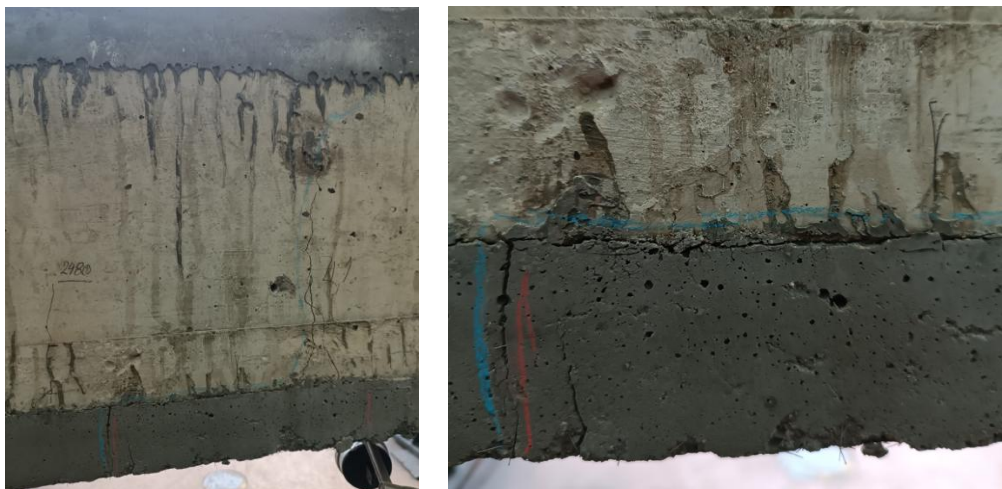
Фиг. 7. Разрушение на гредата
