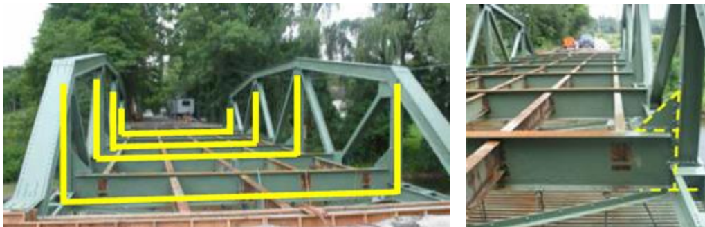
Фиг. 3. U-рамки, осигуряващи устойчивостта на натиснат горен пояс на ферма на мост извън равнината на фермата [4]
