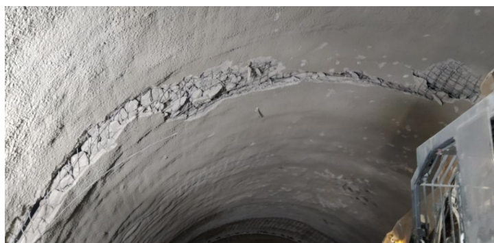
Снимка 1. Счупване на облицовката, перпендикулярно на оста на тунела
