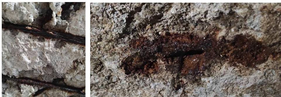
Фиг. 11. Степен на корозия в армировка на партерна плоча – североизточна част
