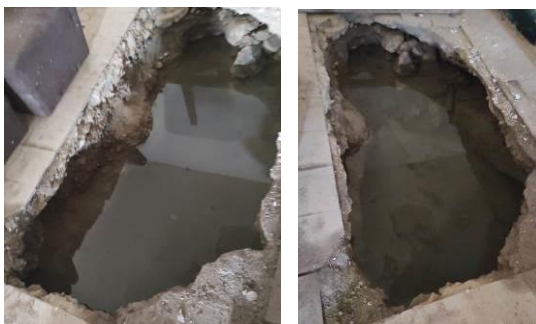
Фиг. 16. Премахната зона от бетонова настилка
