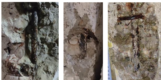
Фиг. 9. Степен на корозия на армировка в колони
