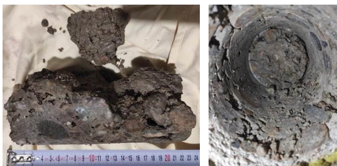
Фиг. 5. Ядково сондиране ПТЗ – непълтна структура на бетона
