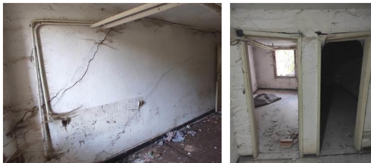
Фиг. 14. Поддаване на ивичен фундамент и бетонова настилка в северната част на сутеренното ниво. Пукнатините в тухлени зидарии
