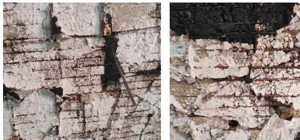
Фиг. 13. Степен на корозия в армировка на покривна плоча
