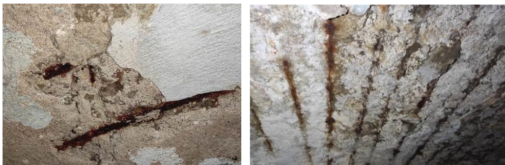
Фиг. 10. Степен на корозия в армировка на партерна плоча – южна част
