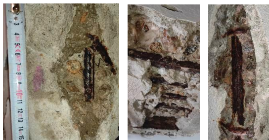
Фиг. 8. Корозия в носещата армировка (греди и колони) на партерна плоча, породена от неплътна структура на бетона и неутрализация на повърхностните бетонни слоеве
