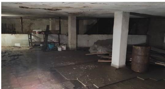
Фиг. 15. Овлажняване (оводняване) на сутеренното ниво (южната част на сградата)
