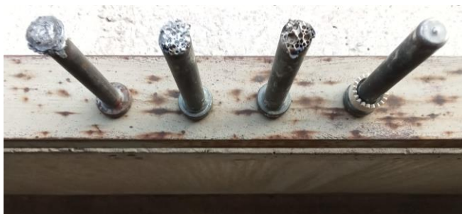
Фиг. 11. Поява на шупли и дефекти в заварките на болтови дюбели (най-дясно – болтов дюбел преди заваряване)
