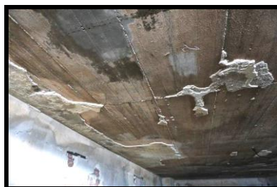
Фиг. 2. Обект А – дефекти плоча
