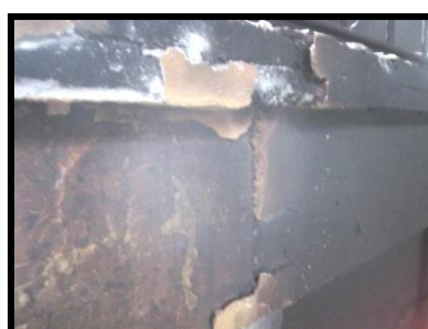
Фиг. 6. Дефект бетоново покритие греда
