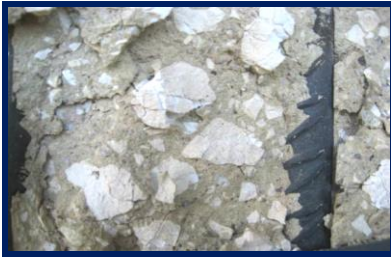
Фиг. 10. Дефектирала армировка
