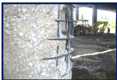
Фиг. 8. Обрушено покритие стълб
