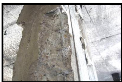
Фиг. 3. Обект Б – дефект покритие колона
