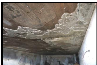
Фиг. 1. Обект А – дефекти мазилка
