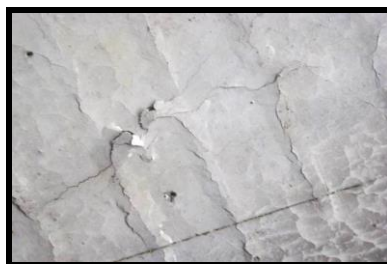
Фиг. 4. Обект Б – дефекти плоча
