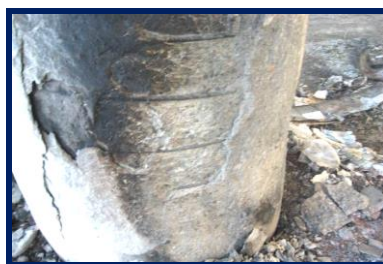
Фиг. 9. Напукано бетоново покритие стълб
