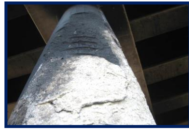
Фиг. 11. Разрушено покритие стълб
