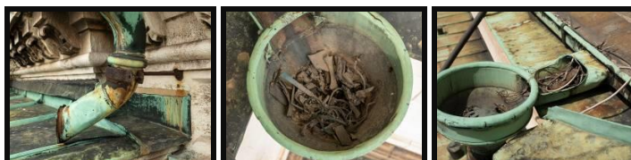
Фиг. 8. Компрометирано покривно водоотвеждане
