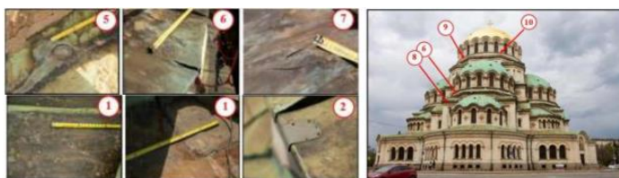
Фиг. 23. Дефекти в обшивката от медна ламарина
