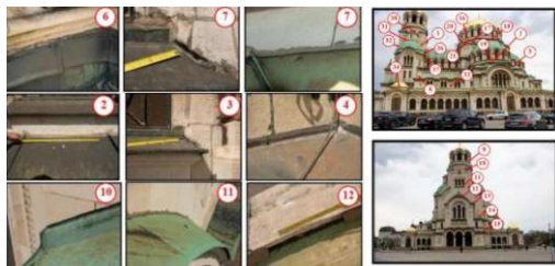
Фиг. 25. Нарушена връзка обшивка-зидария
