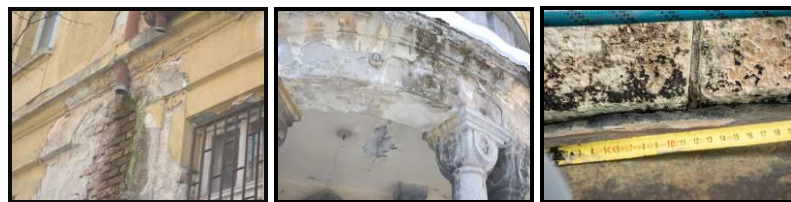
Фиг. 2. Дефекти в резултат на неправилно отводняване
