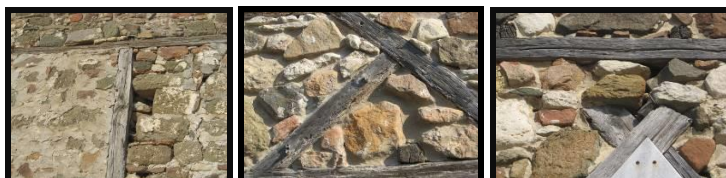
Фиг. 9. Развитие на гнилни процеси при дървени елементи от конструкцията на зида
