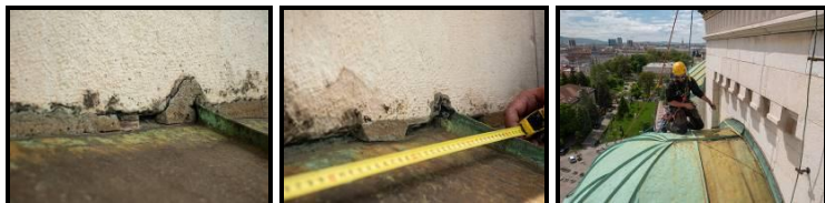
Фиг. 5. Дефектирани обшивки в резултат на ветрови въздействия
