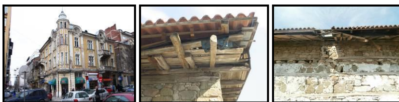
Фиг. 1. Дефекти в покривни конструкции на сгради
