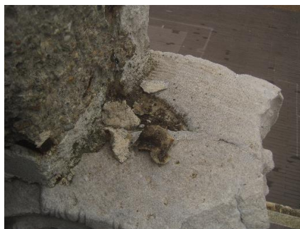
Фиг. 3. Корозия на заварка
