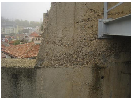
Фиг. 8. Дефекти във видим бетон
