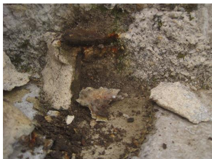
Фиг. 12. Корозия на заварка
