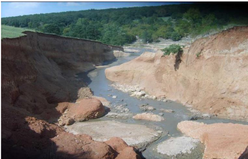
Фиг. 9. Мястото на скъсването през язовирната стена на язовир „Цар Калоян-3“, където се оттичат водите на р. Хлебаровска, поглед по посока на речното корито. Дата: есента на 2007 г. Автор: експерт от община Цар Калоян
