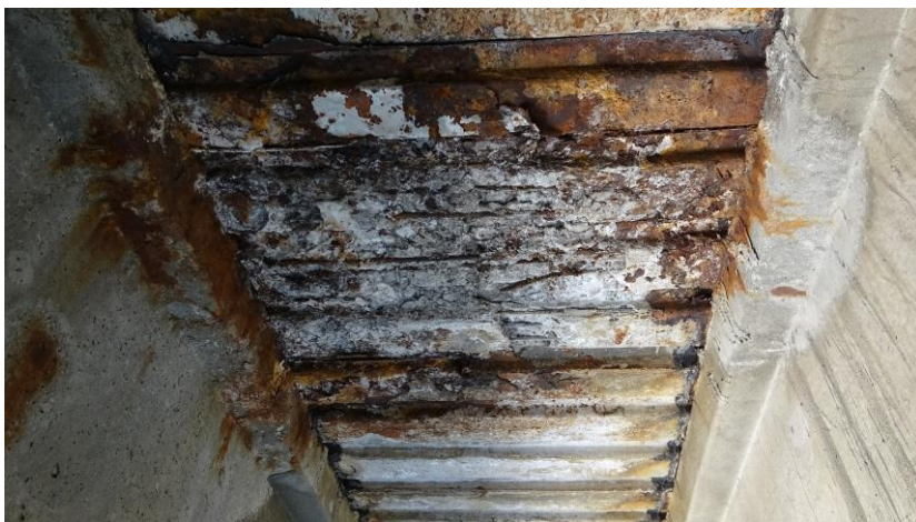
Фиг. 10. Повреди по пътна плоча вследствие на компрометирана хидроизолация
