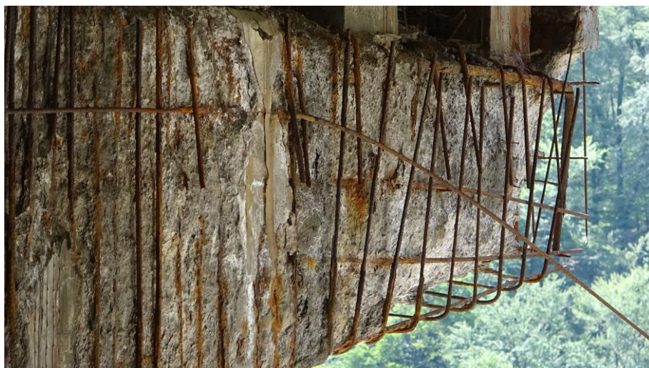
Фиг. 8. Състояние на ригел на стълб С6-д към 26.05.2022 г.
