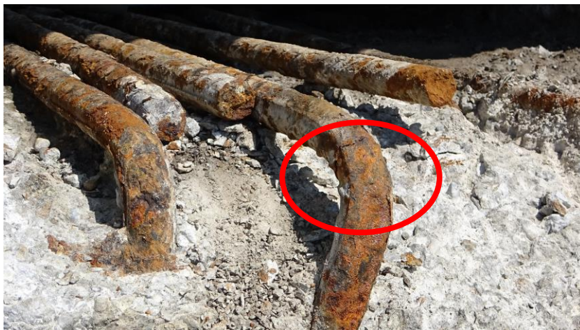
Фиг. 14. Дълбочинна шуплеста корозия на армировка от първи ред. Скъсан прът Ø32 в зоната на огъвката след освобождаването му от бетона
