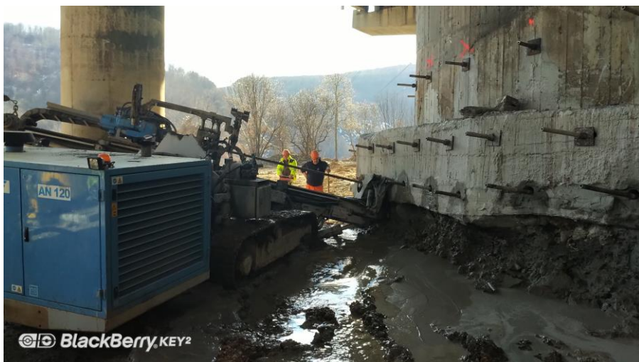
Фиг. 19. Анкерирание на съществуващите стени преди започване на изкопа за новата стена
