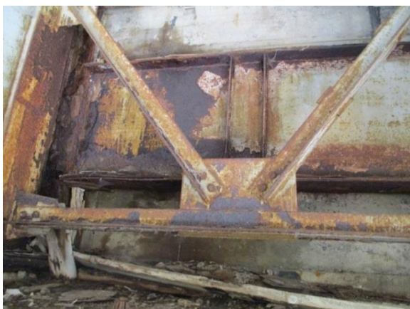
Фиг. 3. МК-1 – корозия в зоната на опорите
