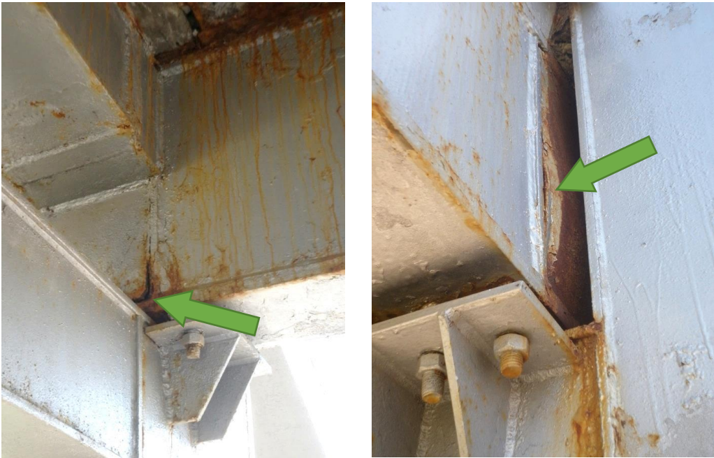
Фиг. 13. Изкорубване и разрушаване по заваръчните шевове между стeблото, пояса и диафрагмата на главната греда
