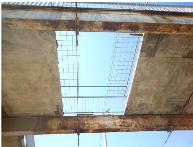
Фиг. 8. Паднал стоманобетонен панел в участъка на трамвайната линия [16]
