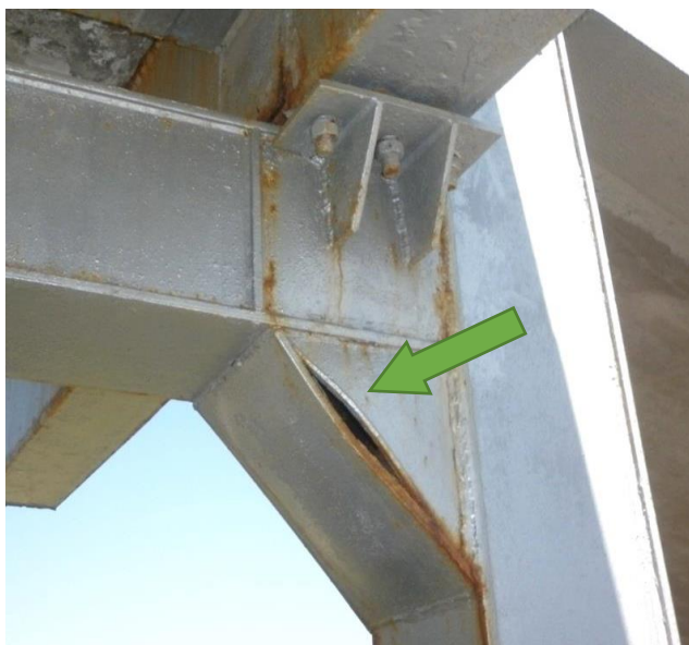
Фиг. 12. Разрушаване по заваръчния шев между стеблото и пояса на вутата
