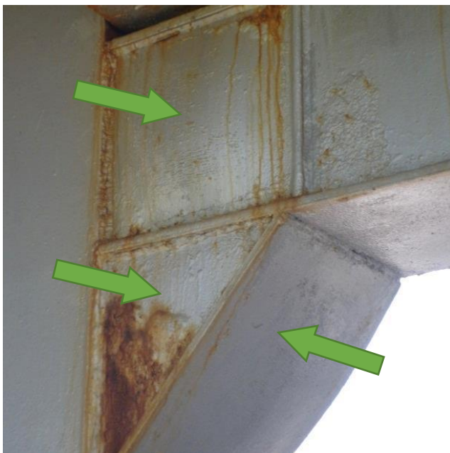
Фиг. 11. Видима местна загуба на устойчивост (изкорубване) в зоната на стъпване на главната греда
