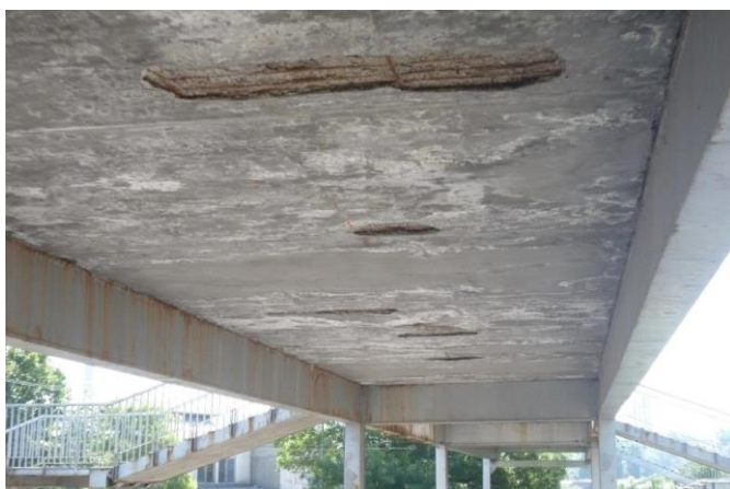
Фиг. 9. Общ вид на пътното платно отдолу – опасност от падане на парчета мазилка и бетон
