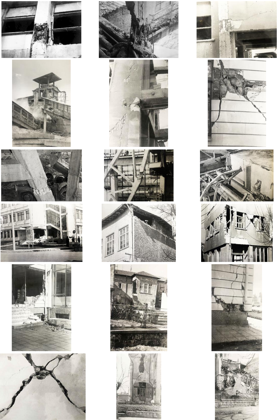
Фиг. 4. Проведи в сгради и съоръжения след земетресението от 04.03.1977 г. в района на гр. Русе, гр. Свищов и др.
