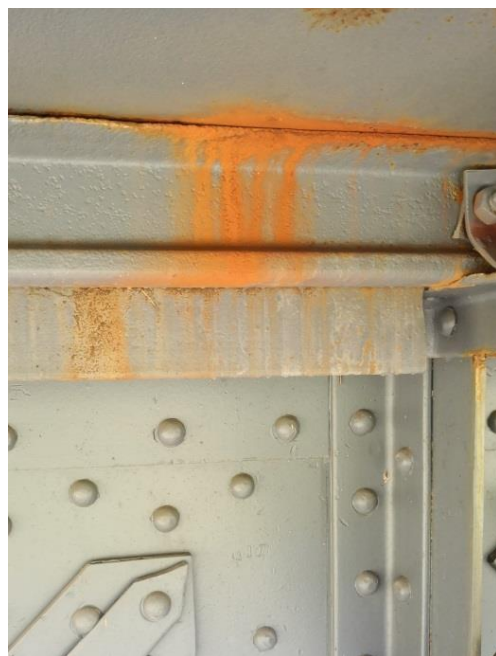
б) корозия по елементите на пешеходните пътеки
