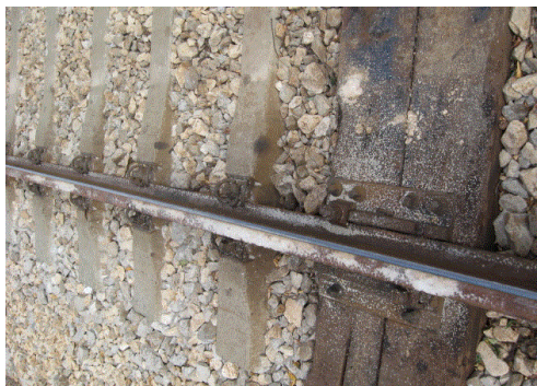
Фиг. 6. Участък със странично износване
