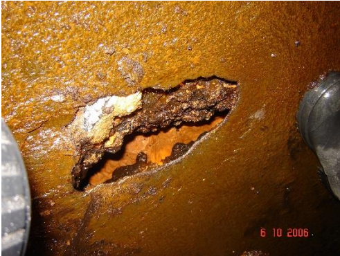
Снимка 5. Характерни нарушения по дъното на тунел Алеко
