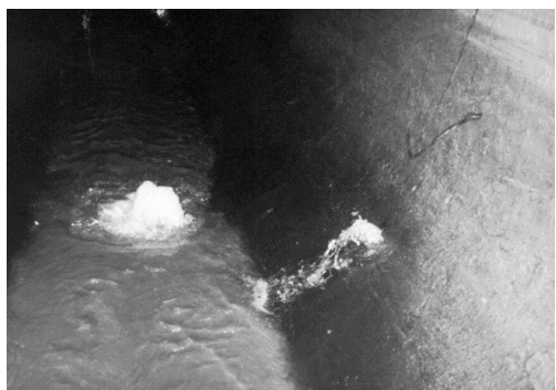
Снимка 3. Нарушение в облицовката на тунел Батак
