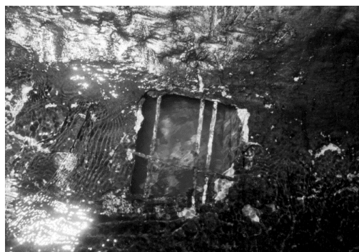
Снимка 1. Нарушение в облицовката на тунел Батак
