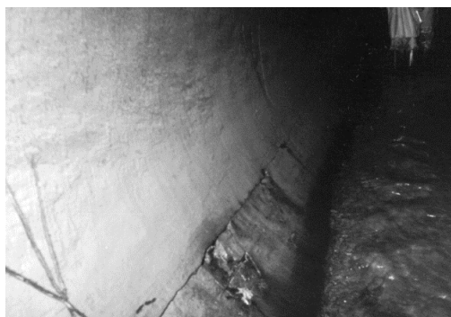
Снимка 2. Надлъжна пукнатина в облицовката на тунел Батак
