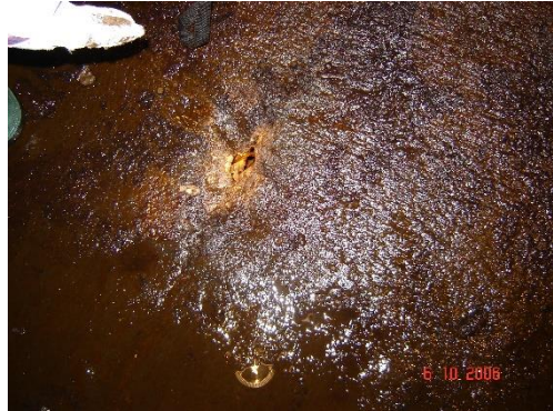
Снимка 6. Характерни нарушения по дъното на тунел Алеко
