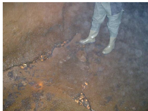
Снимка 10. Тунел Алеко km 6+440 - пропаднало дъно
