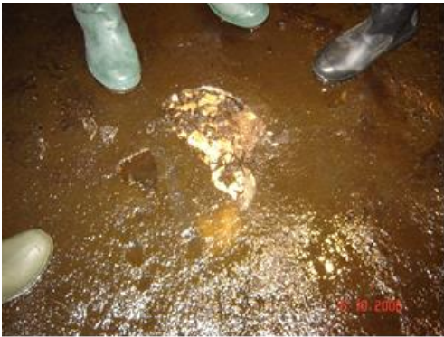
Снимка 7. Характерни нарушения по дъното на тунел Алеко
