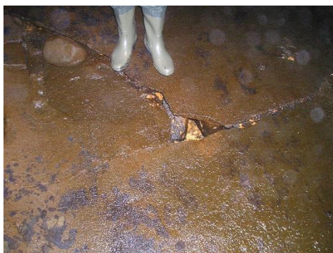
Снимка 11. Тунел Алеко km 6+440 – пропаднало дъно
