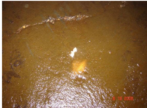
Снимка 8. Характерни нарушения по дъното на тунел Алеко
