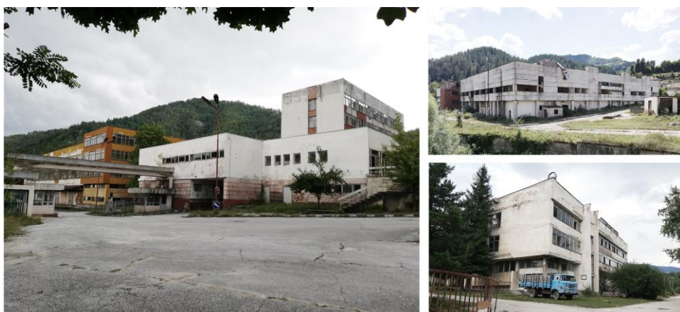
Фиг. 4. Примери за неизползвани индустриални сгради: Завод за каучук, с. Средногорци, общ. Мадан (ляво); (дясно от горе надолу): Тъкачно предприятие в гр. Неделино; Военен завод в гр. Батак
