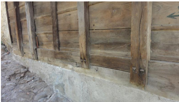
Фиг. 4. Притисквачи, които не се опират в талпите. Във фугата, където липсват летви, се вижда дървена клечка между талпите до притисквача
