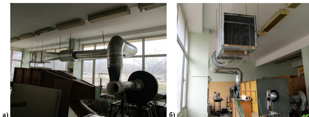
Фиг. 4. Общ вид на въздушния канал а) входна част, б) изходна част
