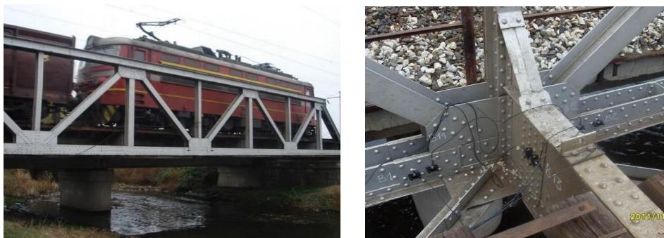
Фиг. 48 и 49. Моменти от проведените изследвания с АЕ на стоманените жп мостове на km 135 +040 преди г. Стамболийски (ляво) и на km 154 +004 в гр. Пловдив (дясно)
