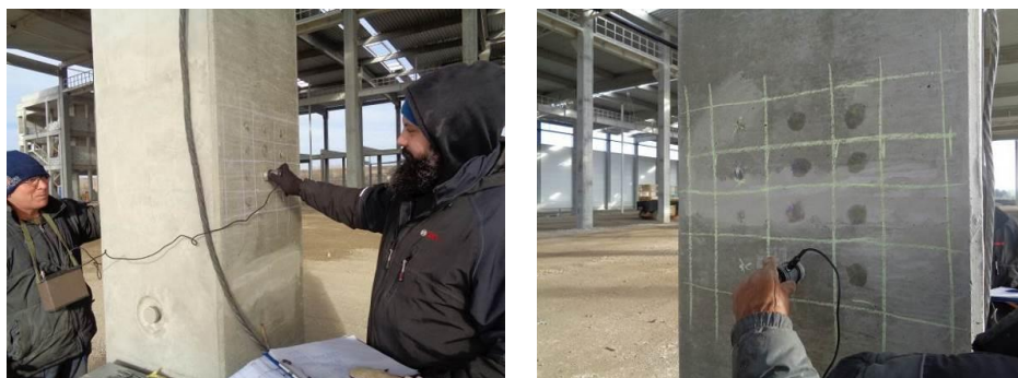
Фиг. 68 и 69. Ултразвукови изследвания за окачествяване на ст.б. колони в новострояща се фабрика за пластмасови съдове в гр. Шумен (2017 г.)
