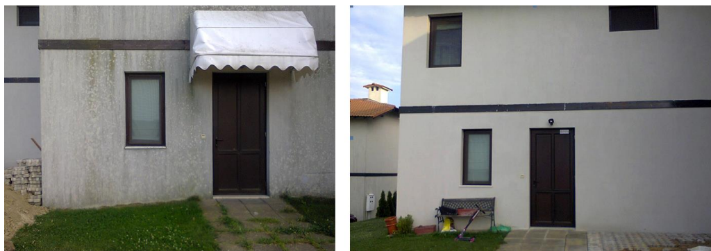
Фиг. 10. Фасадна плоскост, подлежаща на хронично овлажняване (вляво – без обработка с ТКП, където се наблюдават микроводорасли и плесени, и вдясно – след нанасяне на ТКП SuperShield Exterior ефективна защита от микроводорасли, плесени и мухъл)
