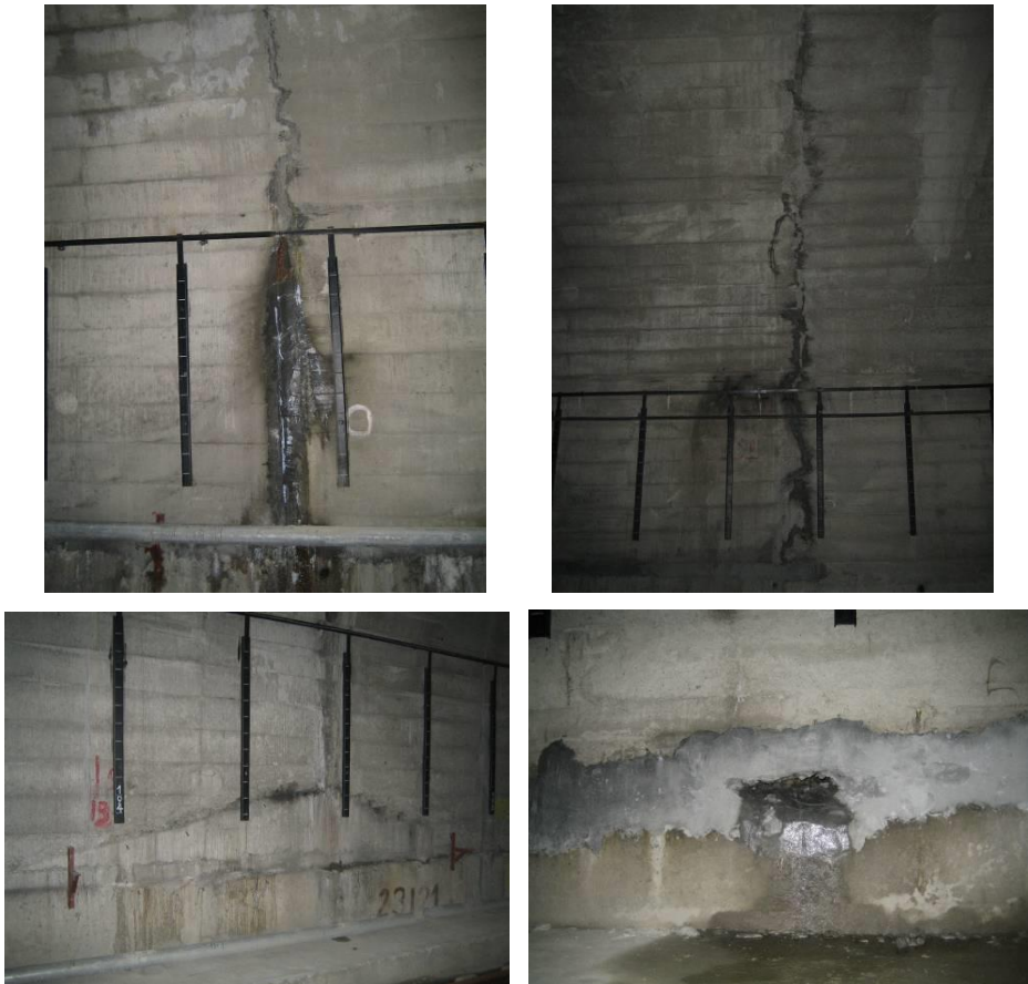
Фиг. 4. Тунел под бул. „Драган Цанков” – течове и овлажняване през работни фуги и пукнатини. Инжектиране на локални течове през работни фуги и/или пукнатини [1]
