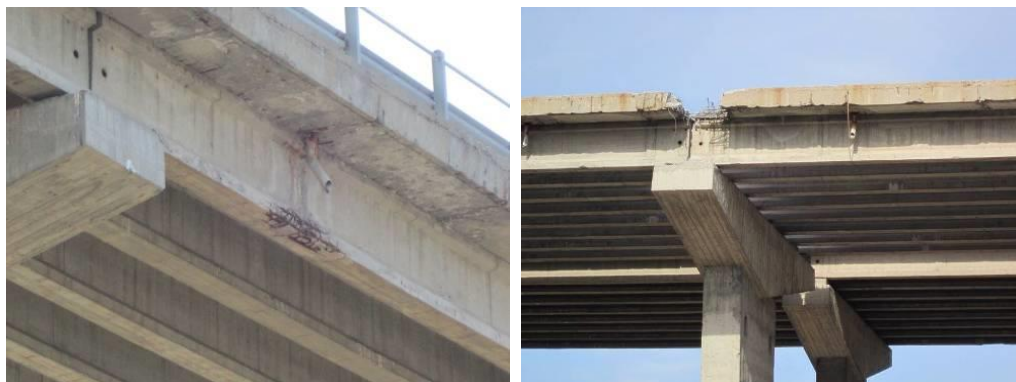
Фиг. 7. Ремонтни дейности на мостове по автомагистрала Хемус в района на тунел Витиня
