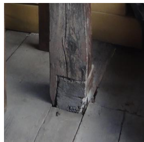
Фиг. 7. Челно зарязване на колоната при опиране върху греда (с. Ковачевица)
