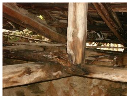
Фиг. 29. Разрушение на надлъжна греда (балантия)
