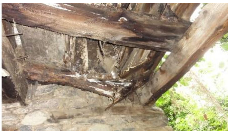
Фиг. 4. Разрушение на греди от подова конструкция вследствие на гниене (с. Лещен)
