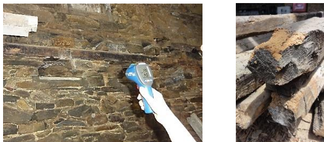
Фиг. 5. Измерване на повърхностната температура на каменната зидария с инфрачервен термометър и състояние на демонтираните греди (Чурилковата къща, с. Ковачевица)
