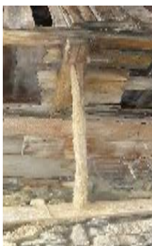
Фиг. 21. Влошаване на подкос под сервисно помещение (с. Ковачевица)
