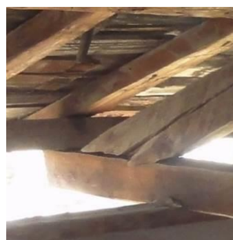
Фиг. 27. Разрушение при задно връзване
