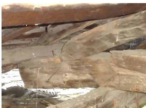
Фиг. 26. Разрушение при предно връзване
