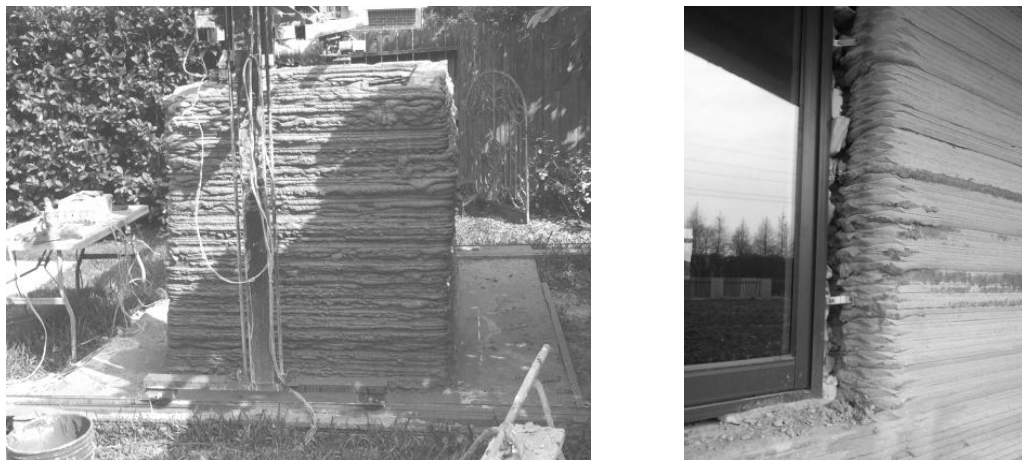
Фиг. 3. Дефекти при изпълнението на 3D-печат на бетон
