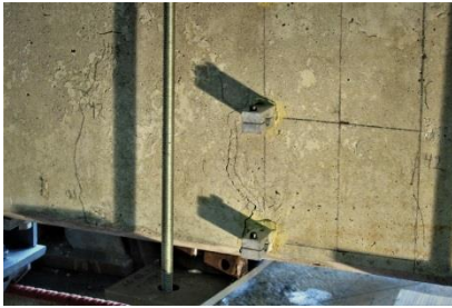
Фиг. 18. Пукнатина в бетона вследствие провлачване на опънната армировка
