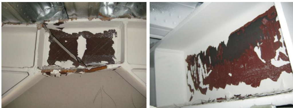
Фиг. 1. Сеизмичен свързващ елемент на рамка от типа EBF в сградата на Pacific Tower след земетресението в Крайстчърч на 22-ри февруари 2011 (снимки на Charles Clifton) [6]
