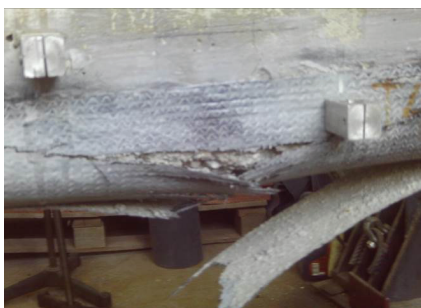
Разрушение на греда СВ0
