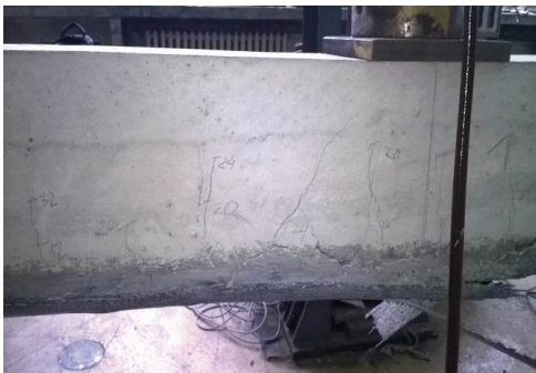
Разрушение на греда СВ1
