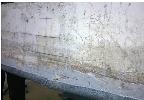
Разрушение на греда СВ3
