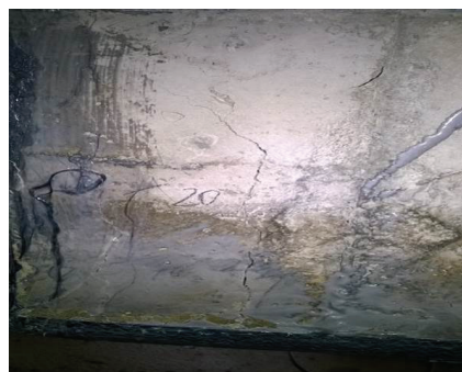
Разрушение на греда СВ2
