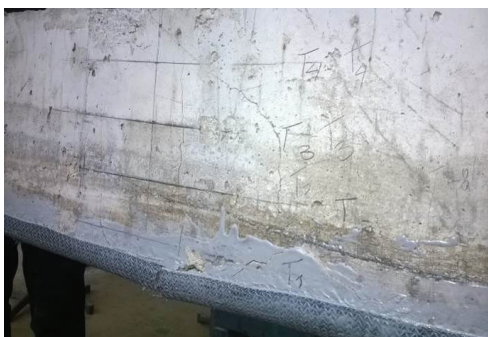
Разрушение на греда СВ3
