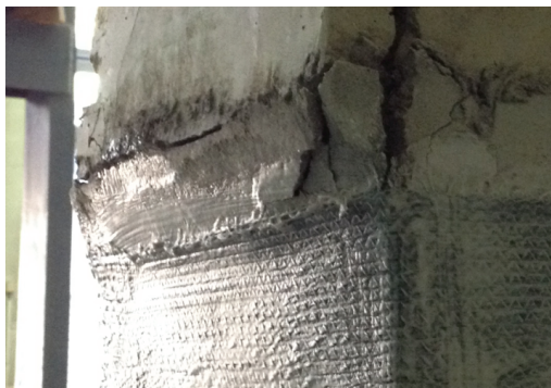
Фиг. 3. Разрушения в горната част на шапката и в колоната
