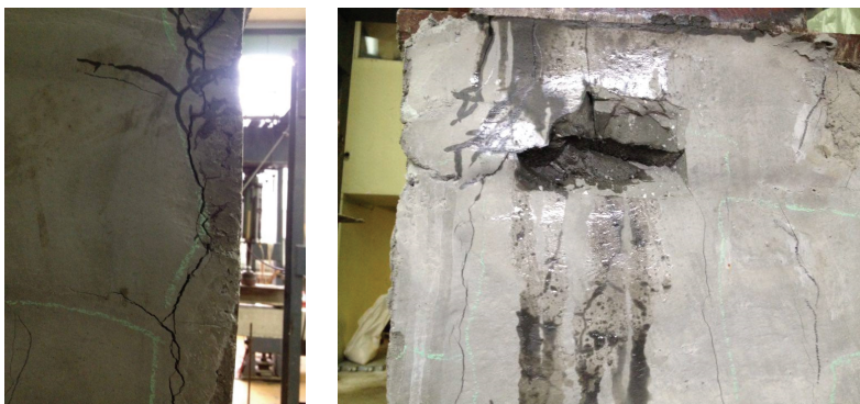
Фиг. 14. Разрушения в колона 5
