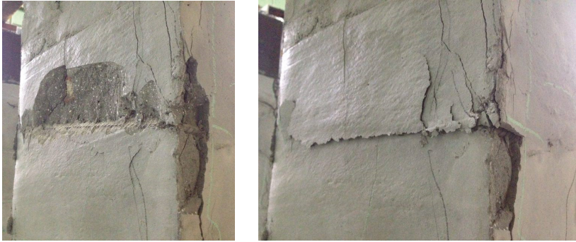
Фиг. 15. Разрушения в колона 6
