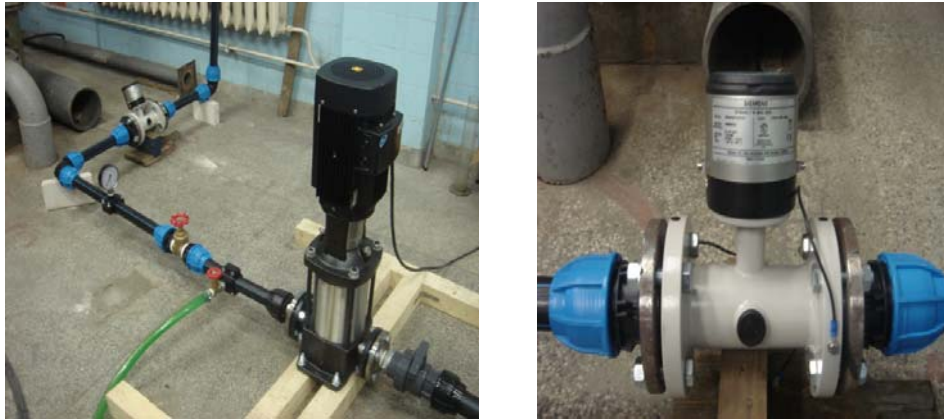
а б Фиг. 6. Помпен агрегат с напорна връзка и измервателни устройства а – помпен агрегат с напорна и байпасна връзка; б – дебитомер
