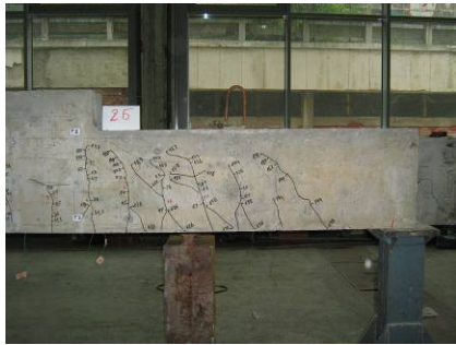
Пукнатини в повреден елемент
