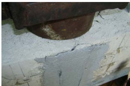
Разрушение в греда В15_5
