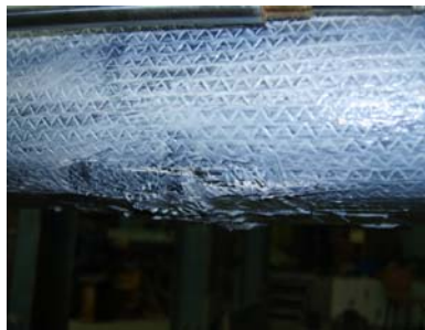
Разрушение на греда B15_4
