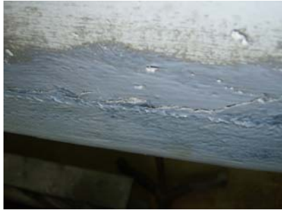
Разрушение на греда B15_1
