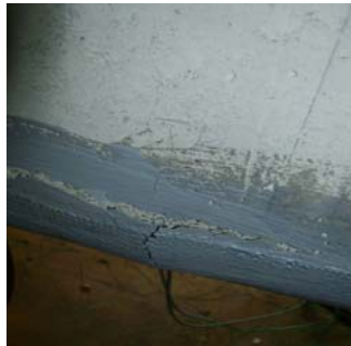
Разрушение в греда B15_2
