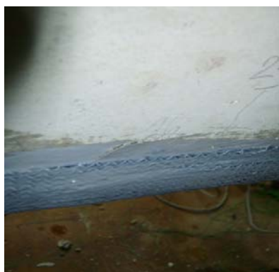
Разрушение в греда В15_6
