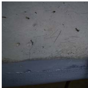
Разрушение в греда B15_3
