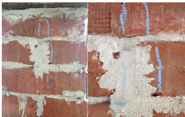
Фиг. 6. Пукнатини в колона 1
