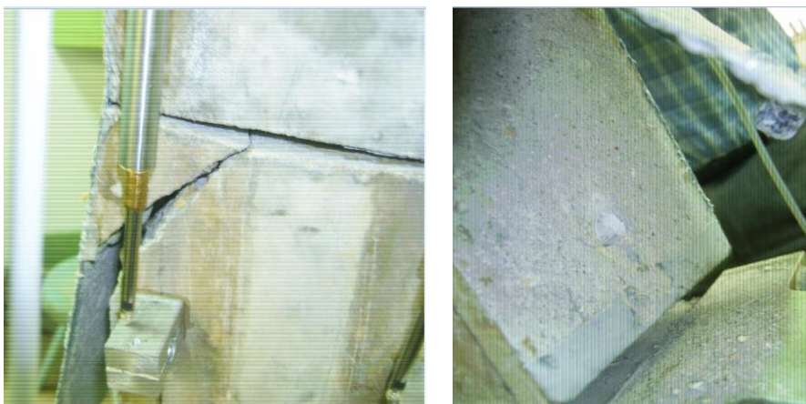
Фиг. 13. Разрушаване на опитните образци и изтръгване на анкера в края
