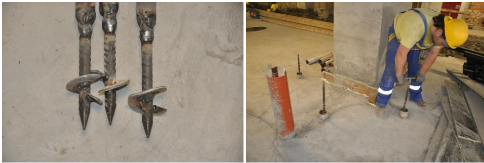
Фиг. 10. Шнекови накрайници на металните пръти и завинтването им на предварително избрана дълбочина под основната плоскост на фундаментната конструкция
