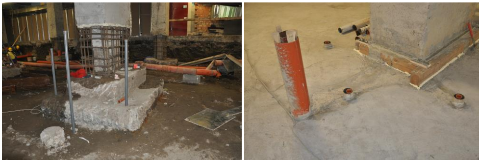
Фиг. 9. PVC тръби, минаващи вертикално и осигуряващи свободното движение на металните пръти – преди и след изпълнението на обединяваща фундаментна плоча
