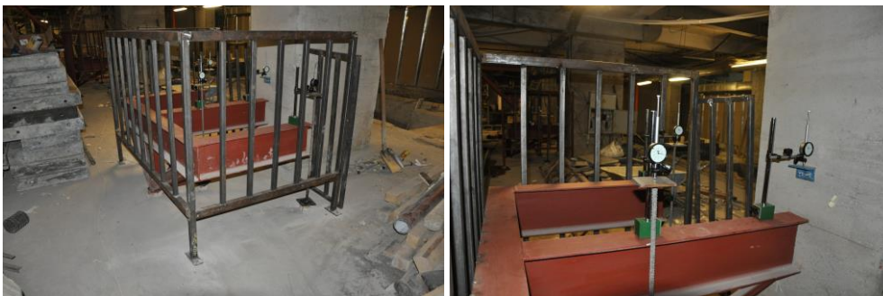
Фиг. 12. Метални стойки (фиксиращи относно глобалното слягане на сградата) и индикаторни часовници, измерващи сляганията
