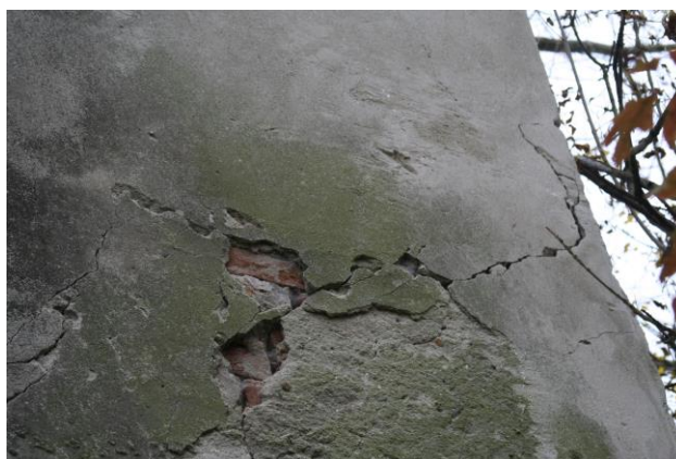
Фиг. 6. Пукнатина на фасадна стена по ос 1
