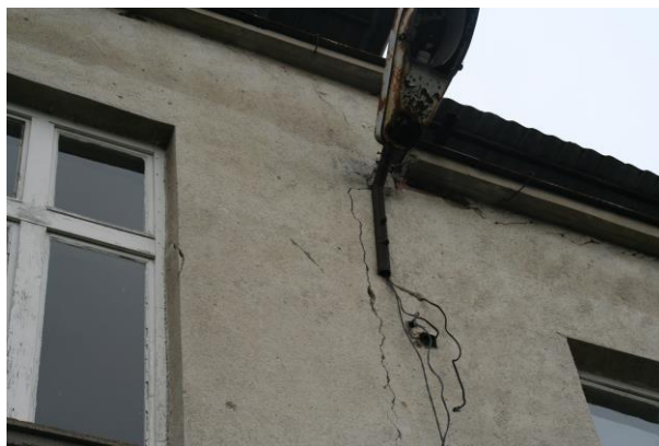
Фиг. 5. Пукнатина на фасадна стена по ос 5
