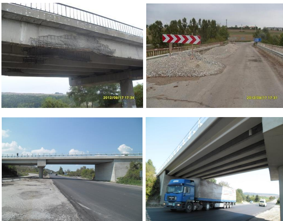
Фиг. 9. Ремонт на връхната конструкция на пътен надлез по ГП 4 м/у В. Търново и Омуртаг
