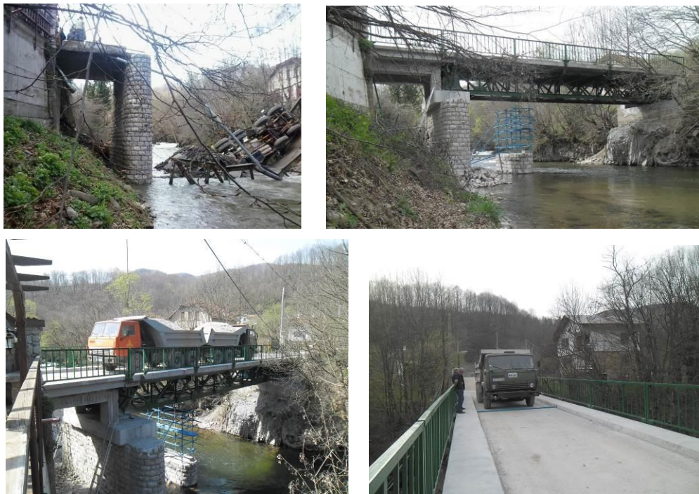
Фиг. 12. Авария и решение за възстановяване на пътен мост над р. Бели Вит в с. Рибарица
