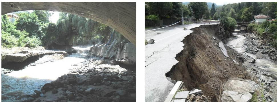
Фиг. 21 и 22. Разрушена корекция на р. Дедевска преди моста в центъра на с. Храбрино и разрушена подпорна стена на пътя, вкл. прагове и буни след същото съоръжение
